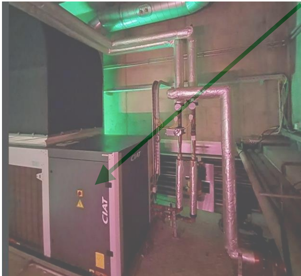
Figuur 8: 01.08 stooklokaal: warmtepomp CIAT: geen asbest
